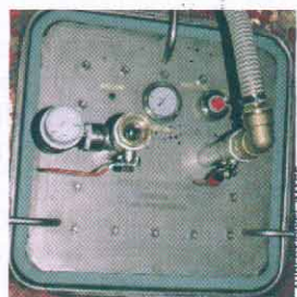
Dès que du vin est soutiré, l'azote arrive par la vanne de droite automatiquement.
